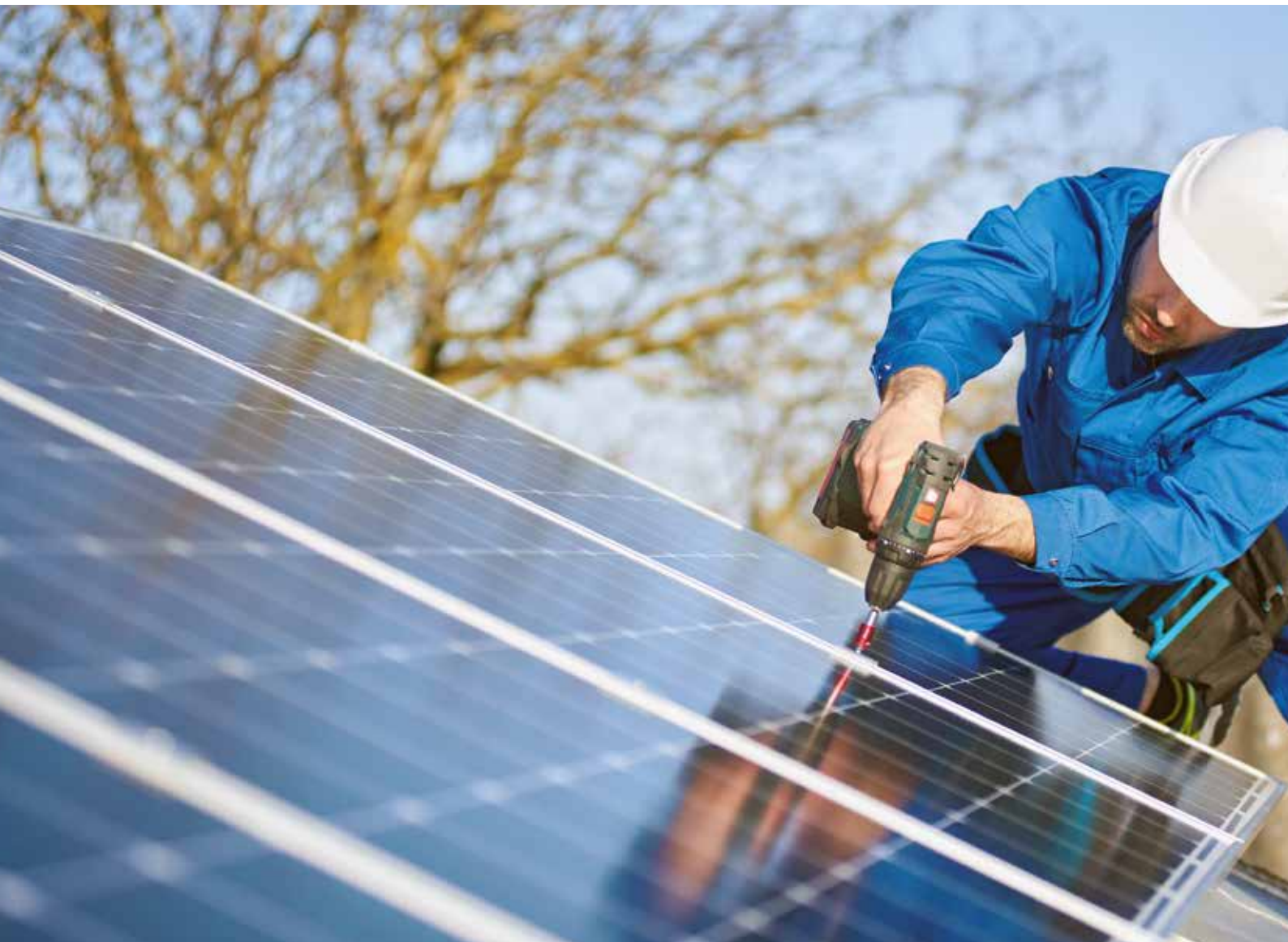
Photovoltaik-Anlagen auf Hausdächern können dabei helfen, umweltfreundlichen Strom zu erzeugen.
